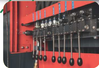
Steuerung 24 Volt-CAN-Bus mit Telemetriemodul für Fernwartung
